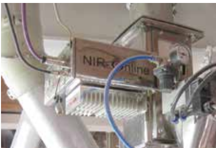
小麦粉配管(バイパス)
