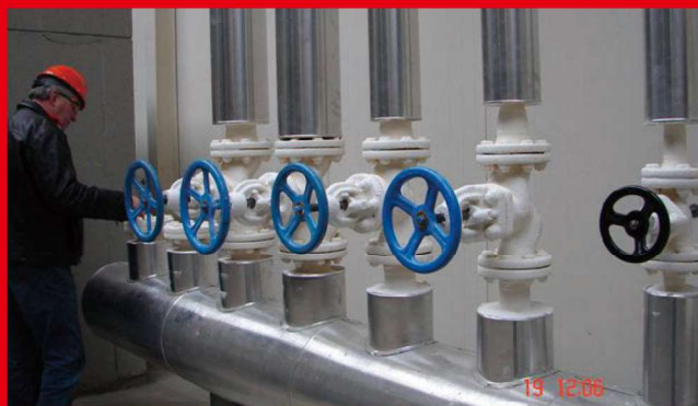
スチームパイプの火傷防止
