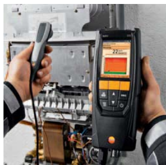
大気COプローブを使い、燃焼設備周辺にCOガスの漏れがないかを検知
